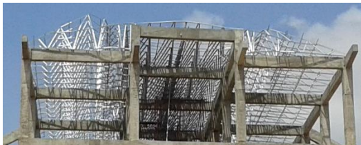
Gambar 1. Keruntuhan pada rangka atap gedung x Pekanbaru
